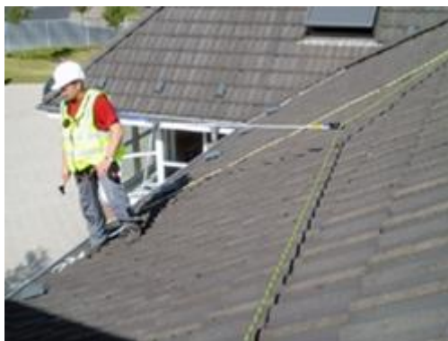
Línea de anclaje provisional
